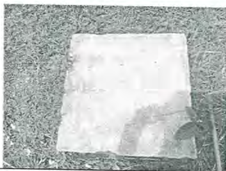
Pozo séptico para efluentes líquidos de la Facultad de Forestales-Zungaro Cocha.
