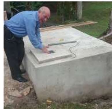
Fotografía 18: Pozo séptico para efluentes líquidos de la facultad de medicina de la UNAP.
